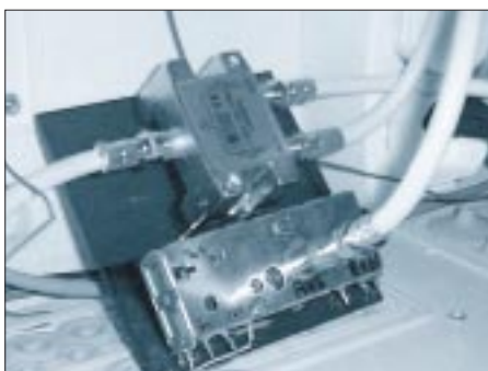
Bild 4: Videomodulator und HF-Koppler zum Einkoppeln des Videosignals in die Sat-TV-Koaxleitung
