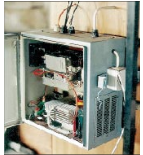
Versorgungsschrank bei DB0FDD (u.a. Netzteil)
