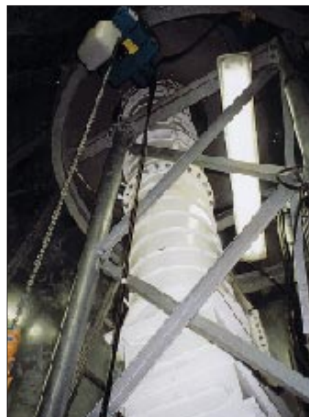
Im Turm der 48-m-Parabolantenne. Es dominiert der Wellenleiter, der die Energie zum Brennpunkt des Spiegels führt.
